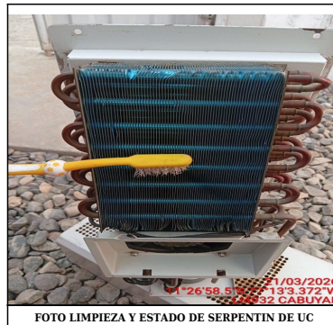
FOTO LIMPIEZA Y ESTADO DE SERPENTIN DE UC
