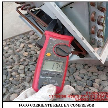
FOTO CORRIENTE REAL EN COMPRESOR
