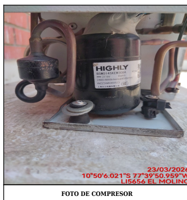
FOTO DE COMPRESOR
