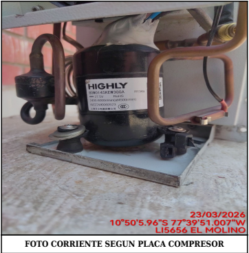
FOTO CORRIENTE SEGUN PLACA COMPRESOR
