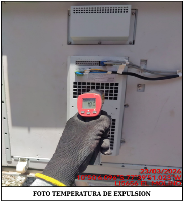
FOTO TEMPERATURA DE EXPULSION
