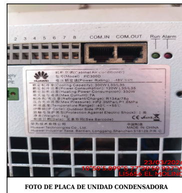
FOTO DE PLACA DE UNIDAD CONDENSADORA
