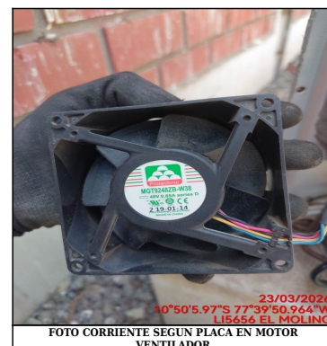
FOTO CORRIENTE SEGUN PLACA EN MOTOR VENTILADOR
