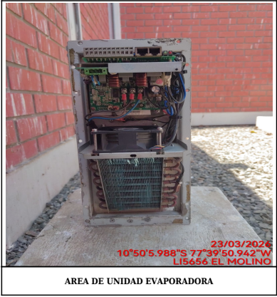
AREA DE UNIDAD EVAPORADORA
