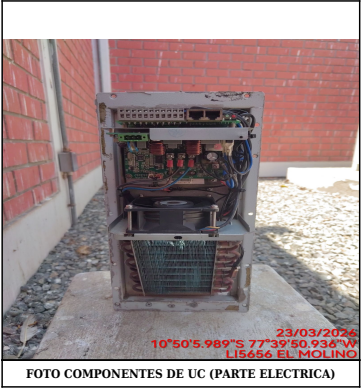
FOTO COMPONENTES DE UC (PARTE ELECTRICA)
