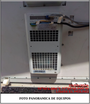
FOTO PANORAMICA DE EQUIPOS
