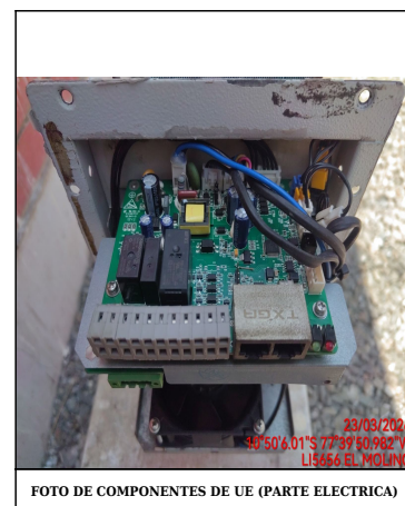
FOTO DE COMPONENTES DE UE (PARTE ELECTRICA)
