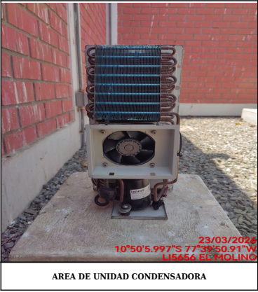
AREA DE UNIDAD CONDENSADORA
