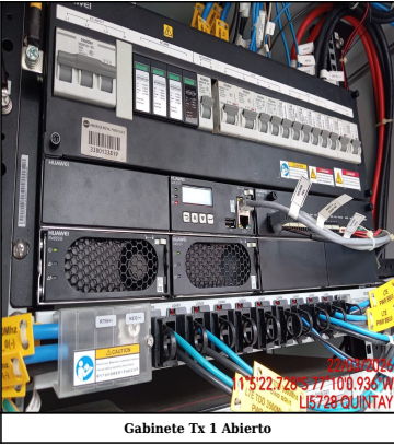
Gabinete Tx 1 Abierto
