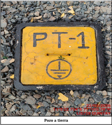
Pozo a tierra
