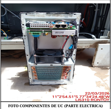
FOTO COMPONENTES DE UC (PARTE ELECTRICA)
