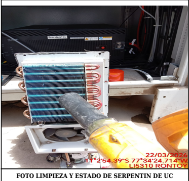
FOTO LIMPIEZA Y ESTADO DE SERPENTIN DE UC
