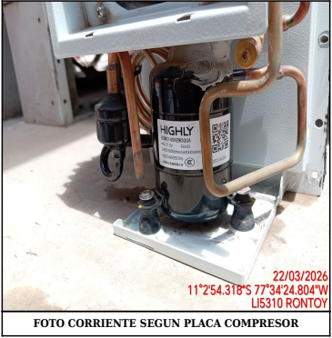
FOTO CORRIENTE SEGUN PLACA COMPRESOR
