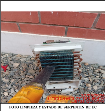
FOTO LIMPIEZA Y ESTADO DE SERPENTIN DE UC
