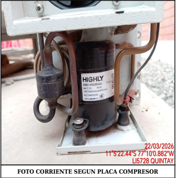
FOTO CORRIENTE SEGUN PLACA COMPRESOR
