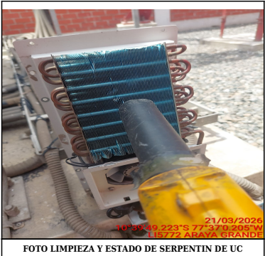
FOTO LIMPIEZA Y ESTADO DE SERPENTIN DE UC
