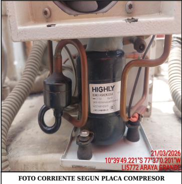
FOTO CORRIENTE SEGUN PLACA COMPRESOR
