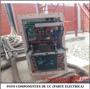
FOTO COMPONENTES DE UC (PARTE ELECTRICA)
