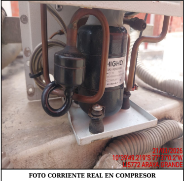
FOTO CORRIENTE REAL EN COMPRESOR
