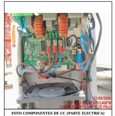
FOTO COMPONENTES DE UC (PARTE ELECTRICA)
