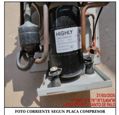
FOTO CORRIENTE SEGUN PLACA COMPRESOR
