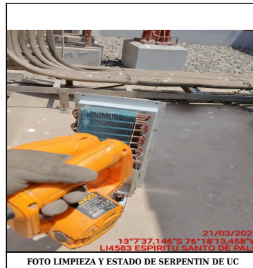
FOTO LIMPIEZA Y ESTADO DE SERPENTIN DE UC
