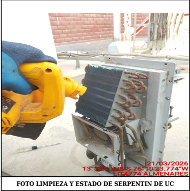
FOTO LIMPIEZA Y ESTADO DE SERPENTIN DE UC
