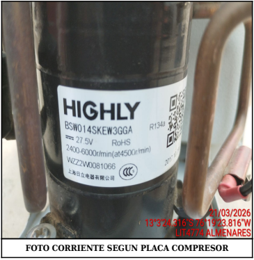
FOTO CORRIENTE SEGUN PLACA COMPRESOR
