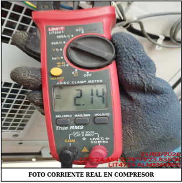
FOTO CORRIENTE REAL EN COMPRESOR
